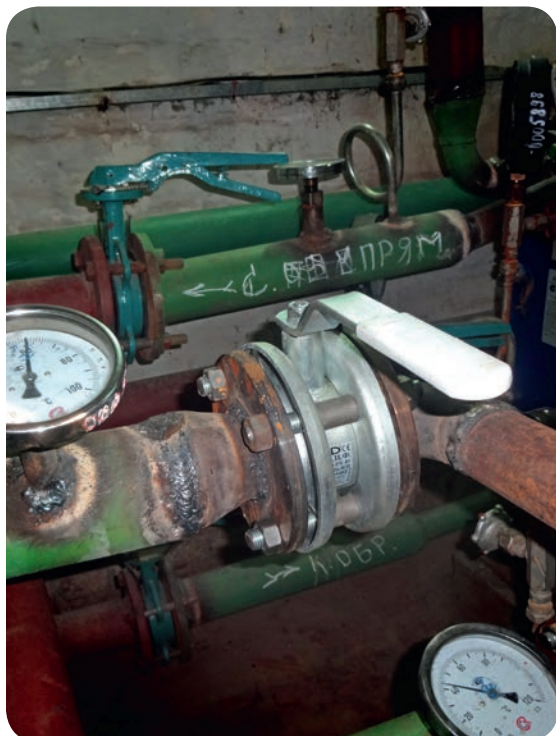
ТЕПЛОПУНКТ (ОБВЯЗКА ТЕПЛООБМЕННИКА)
