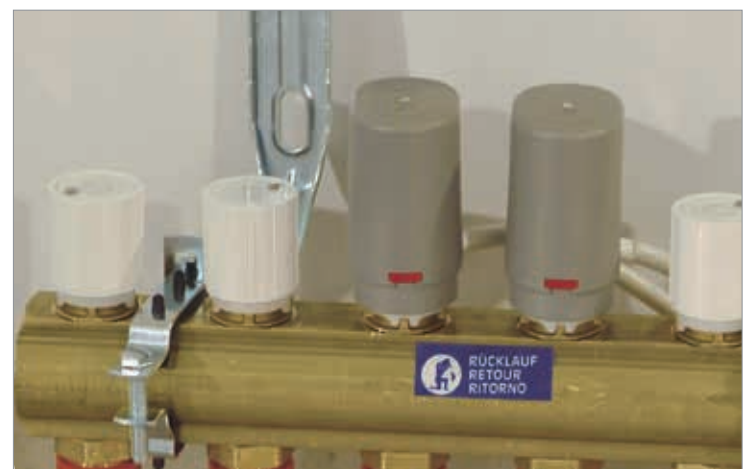
Рисунок 9. Электротермические сервоприводы, установленные на коллектор.
