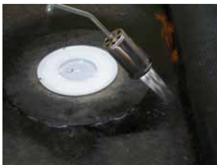
2. Приварить гидроизоляционный фартук трапа к первому слою гидроизоляции (в нахлест). Второй слой гидроизоляции в нахлест наплавляется сверху (до крепежного фланца)
